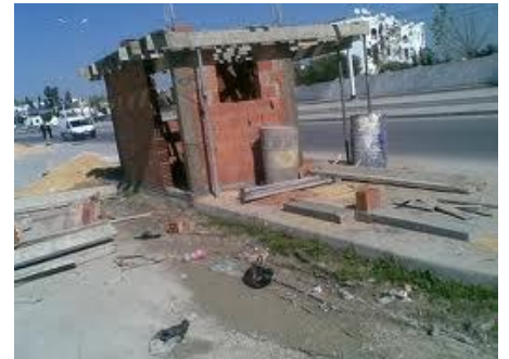
تجنب البناء الفوضوي
